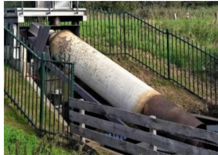
Foto 12 Visvriendelijk vijzelgemaal Koopmanspolder
